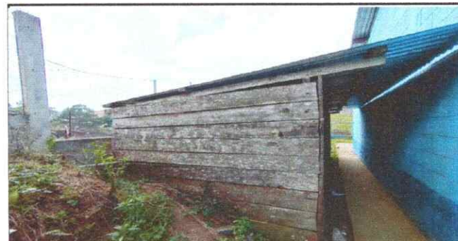
SUSTITUCION DE TECHO DEL BAÑO POR DETERIORO
